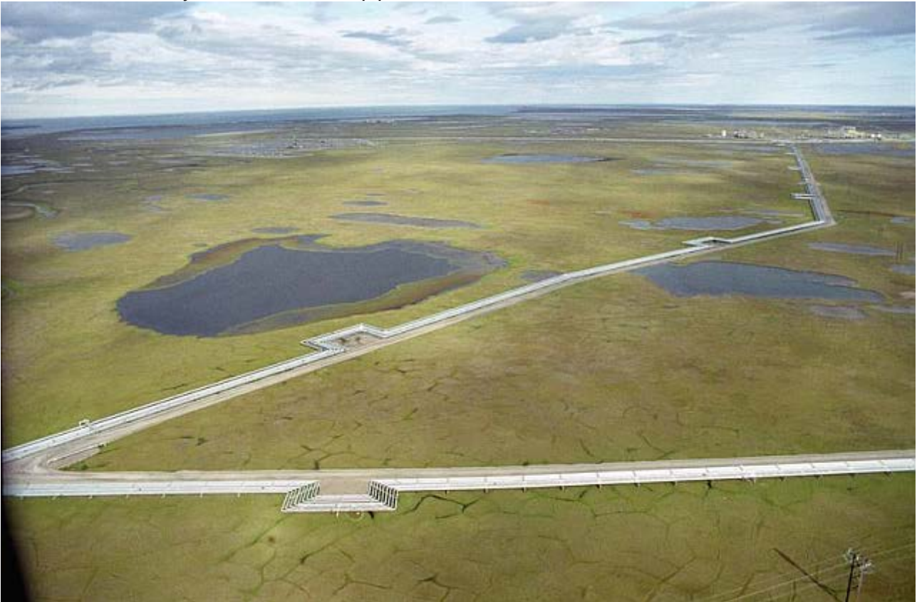
Abb.46 Prudhoe Bay/USA: Beheizte Ölpipeline auf Permafrost-Boden im Norden von Alaska
